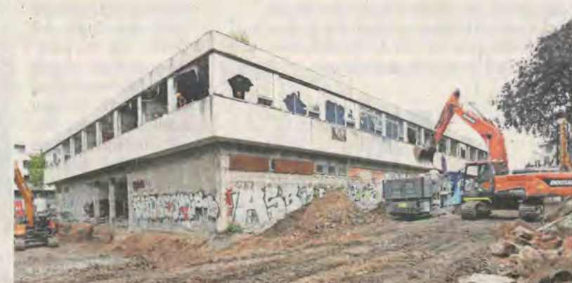
Etlliche Bagger haben mit der Arbeit begonnen - so sieht es jetzt auf der Baustelle aus. FOTOS: ANDRÉ KEMPNER
