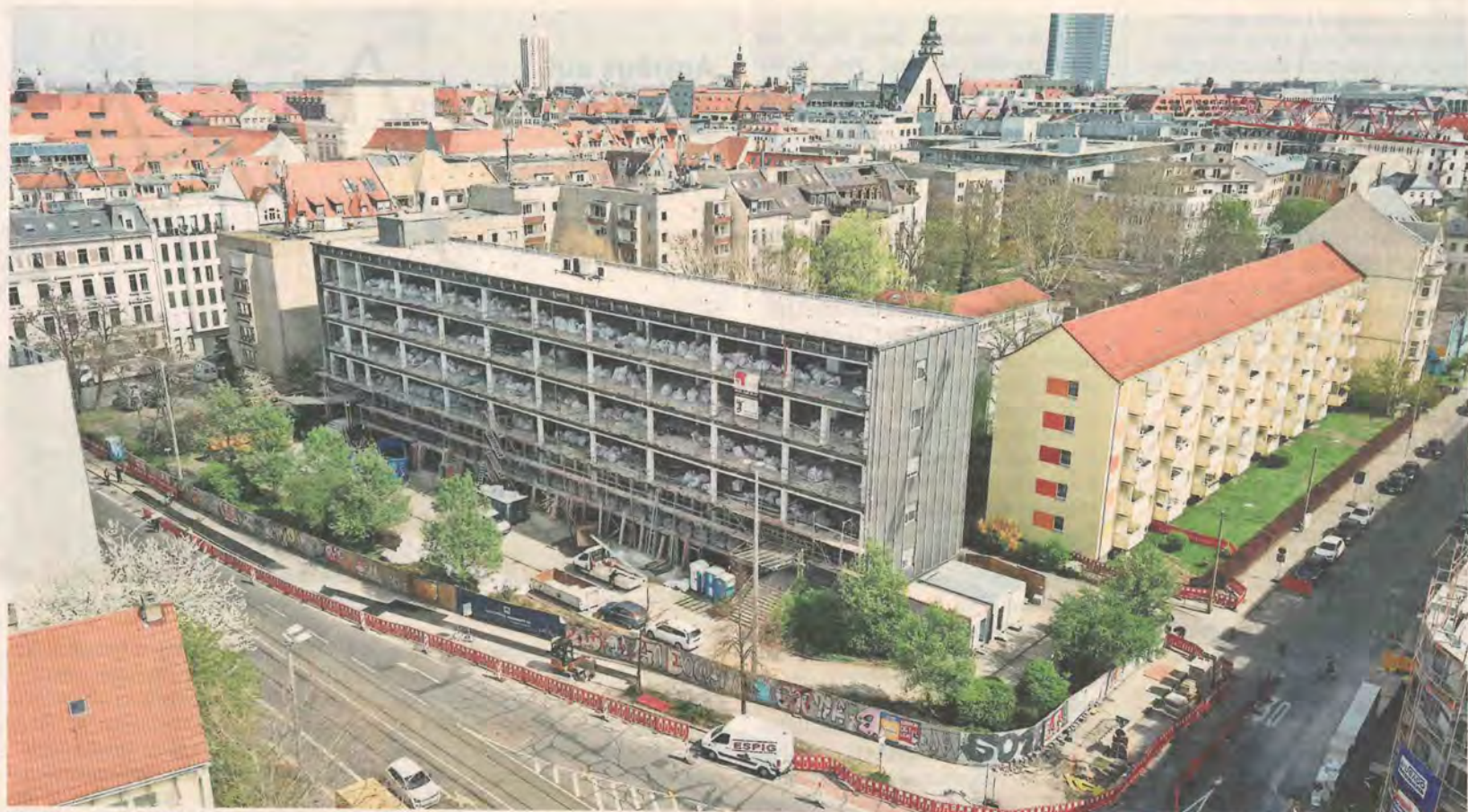
Die frühere PwC-Niederlassung in der Käthe-Kollwitz-Straße wird zurzeit saniert und um einen Neubau ergänzt, der die Firmenzentrale der Quarterback Immobilien AG aufnehmen soll.
