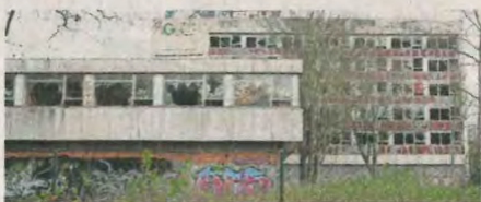
Verfallen: das „Gästehaus am Park“
