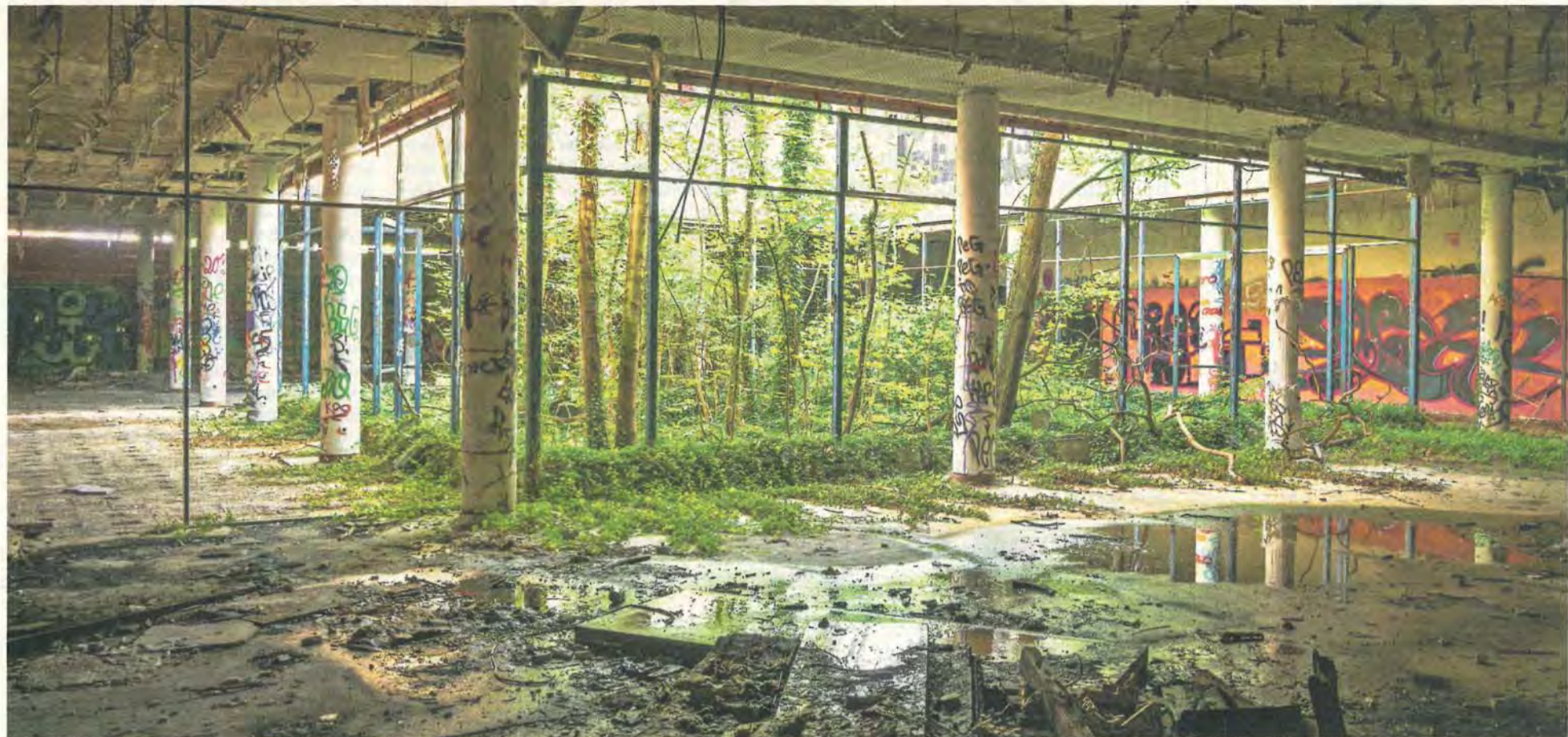
Das ehemalige Gästehaus der DDR-Regierung steht seit knapp einem Vierteljahrhundert leer. Vandalismus und ein Brand haben dem Bau schwer zugesetzt. Quelle: Stadt Leipzig, Urheber: Roland Qvester
